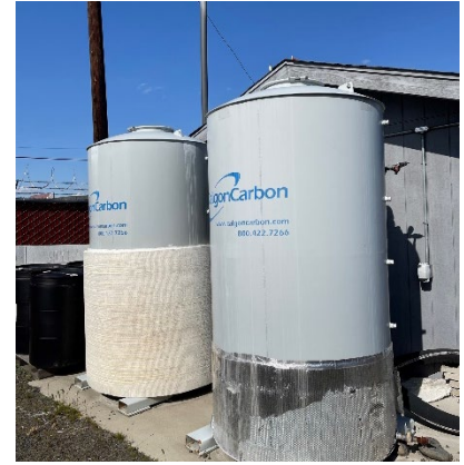
Filtros de carbón en sitio para tratar vapores.
